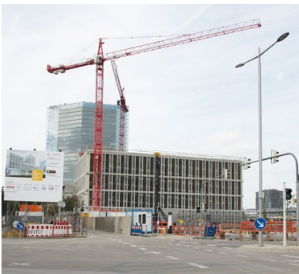
Baufortschritt im Glückstein-Quartier (Sommer 2018). Quelle: Presse-Büro Warlich im Auftrag der Stadt Mannheim
